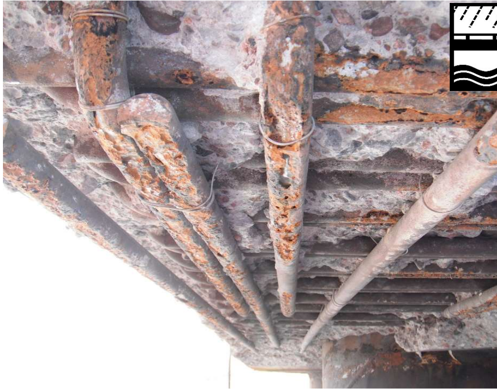
Corrosion des armatures du béton
