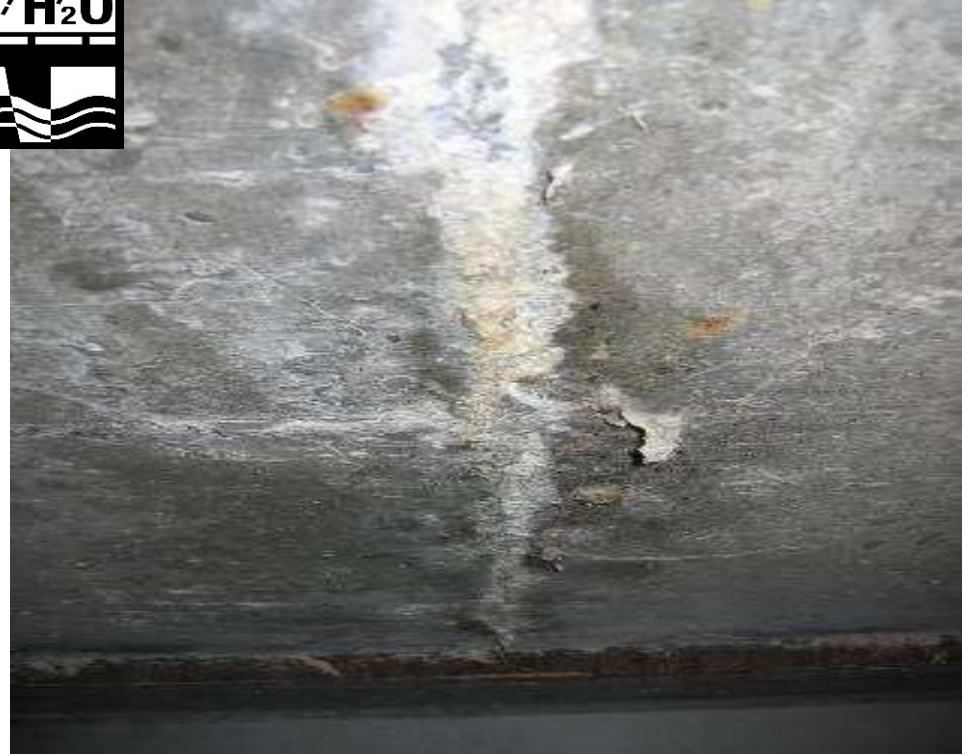
Fissures avec lixiviation
