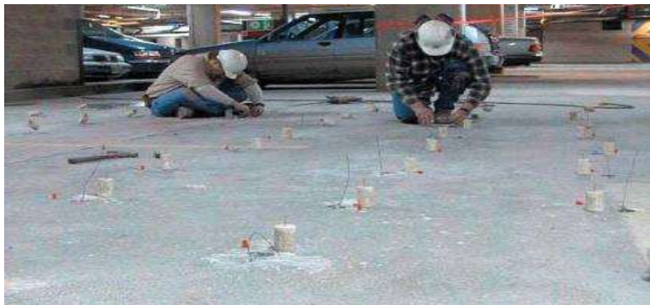
Anodes discrètes installées pour prévenir la corrosion dans un parking.
